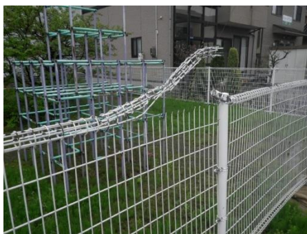
公園フェンス破損の確認
