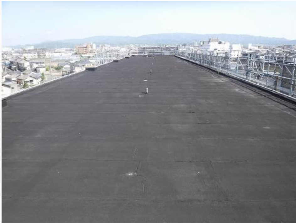
ひび割れした屋上床面から漏水
