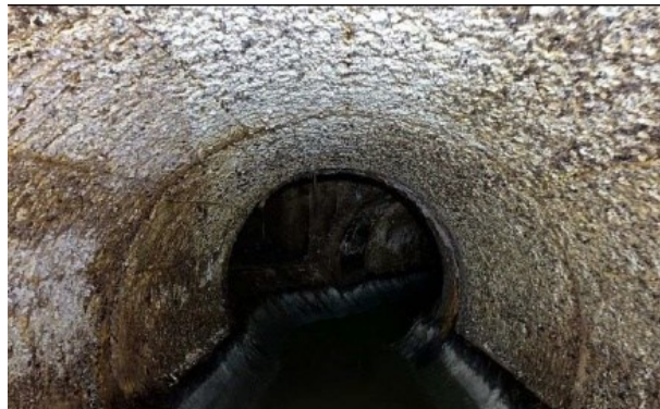
管の腐食から緊急度 I と判定
