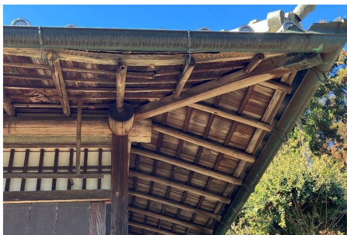
図 22 劣化状況 (軒回りの木部破損・腐朽) 22
