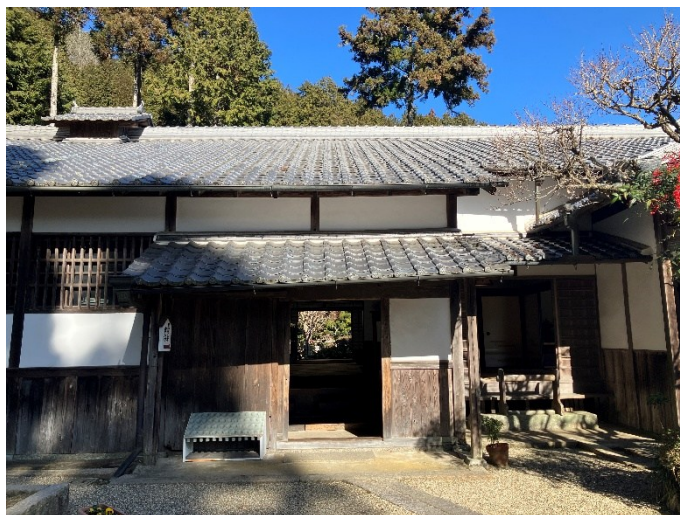
図 21 劣化状況(屋根面のうねり) 21
