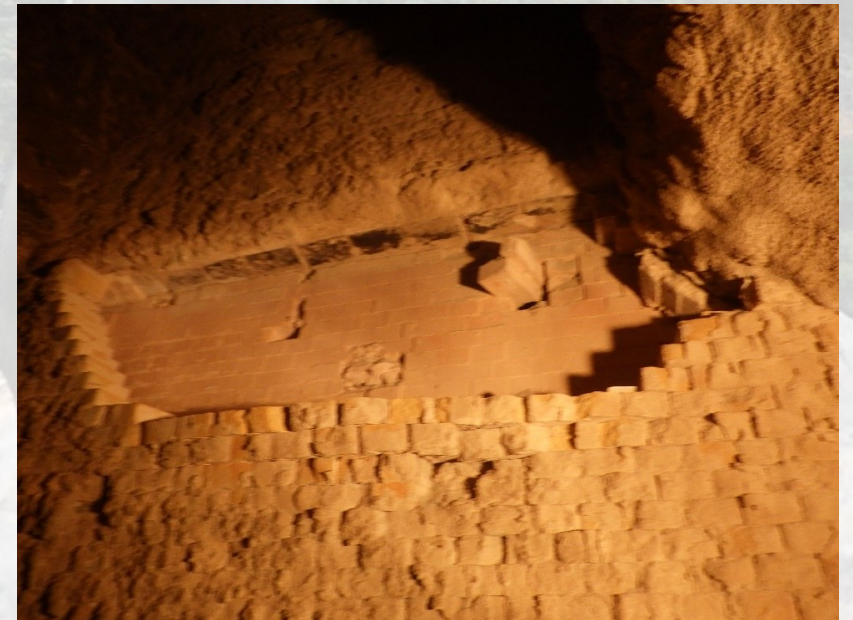
(焼却施設の耐火煉瓦の崩落箇所)
