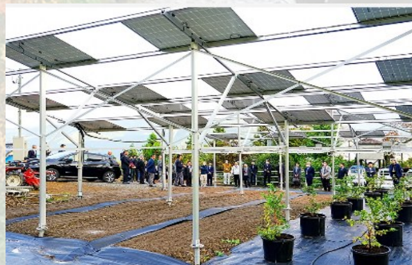
完成したソーラーシェアリング
