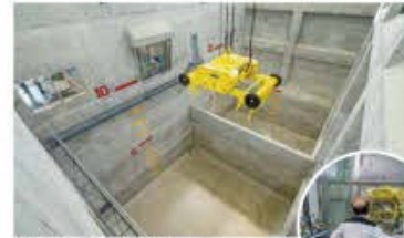
ごみピット・ごみクレーン
