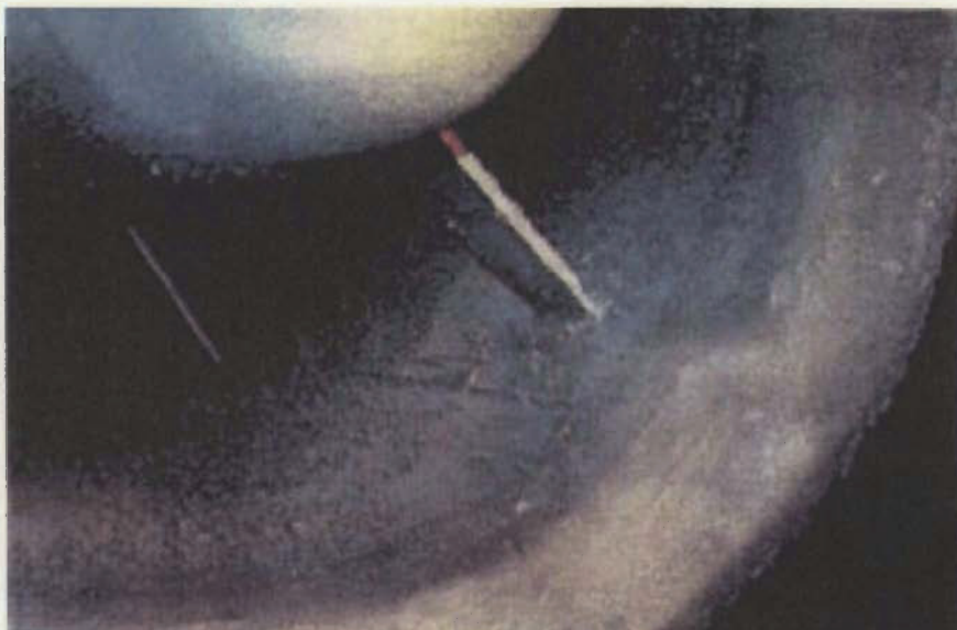
写真－5 ケーシング内部のパンチングプレート部：ダスト付着〔有〕
