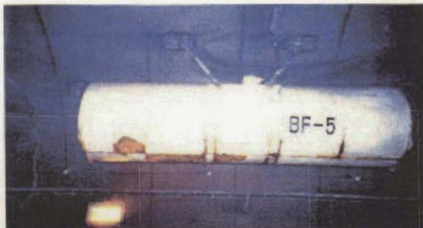
写真-3 発錆、腐食状態のランク：[D]
