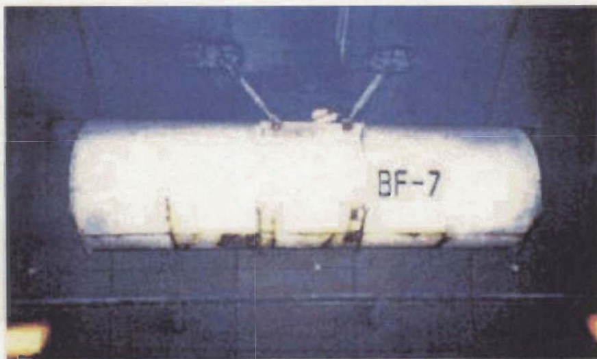
写真－2 発錆、腐食状態のランク：[C]
