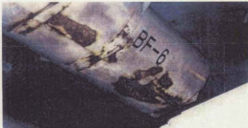
写真-4 発錆、腐食状態のランク：[E]
