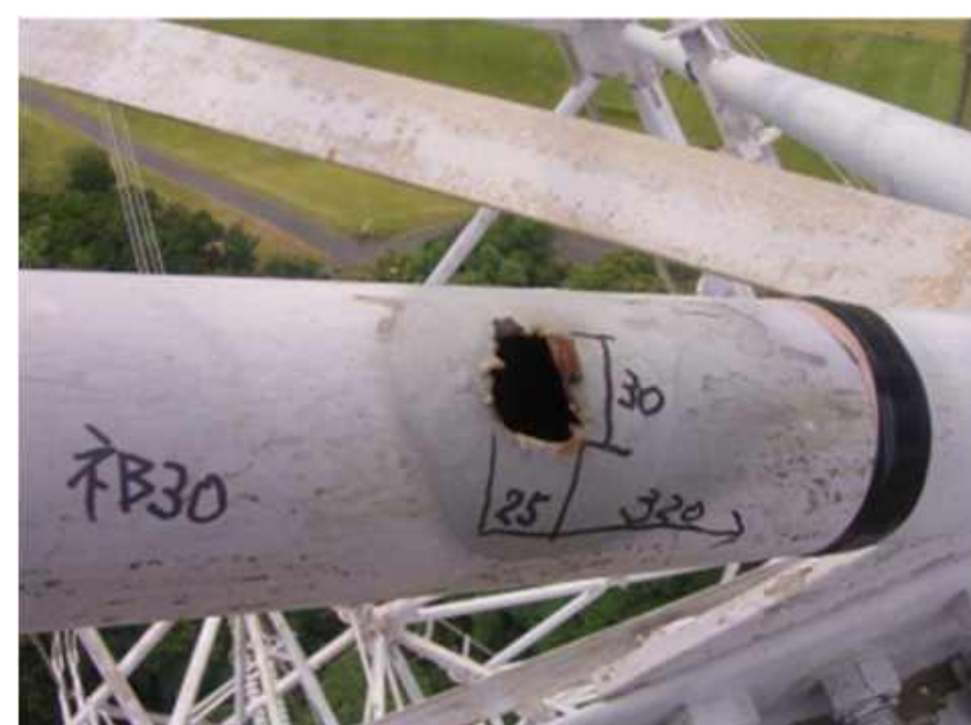
鋼管鉄塔穴あき
