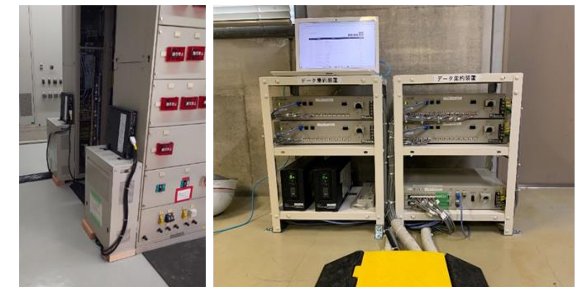
データ集約装置の設置例
