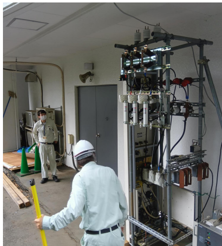
模擬用高圧受電設備
