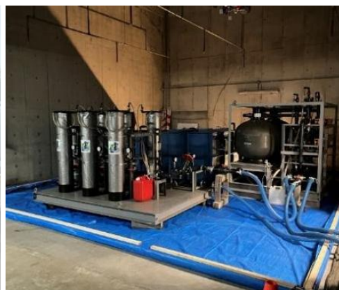
消火用貯水槽の浄化例
