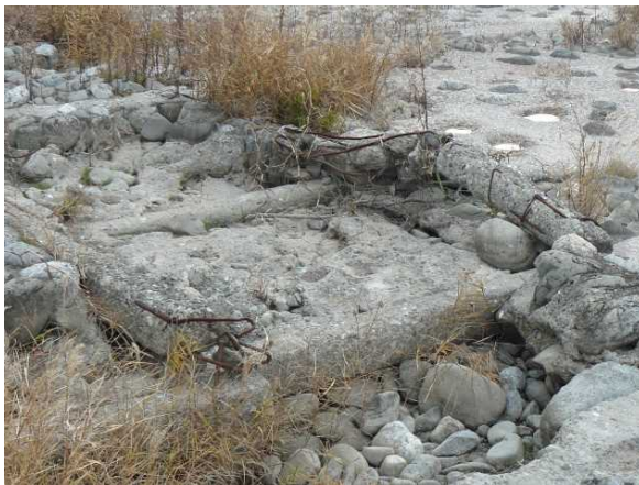
写真 2-38 護床工の損傷、摩耗
