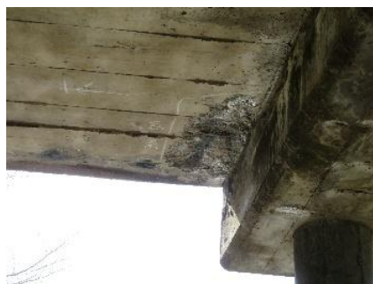
アドバイザーが確認した 橋梁の劣化状況の様子
