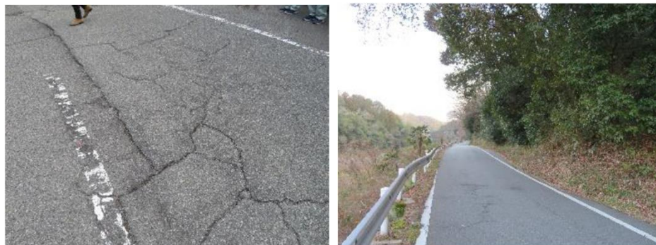
アドバイザーによる、現地踏査での課題の特定(舗装ひび割れ、法面除草・管理)
