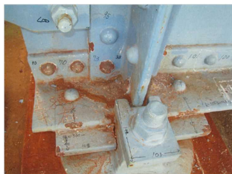
支点部における下フランジの疲労き裂
