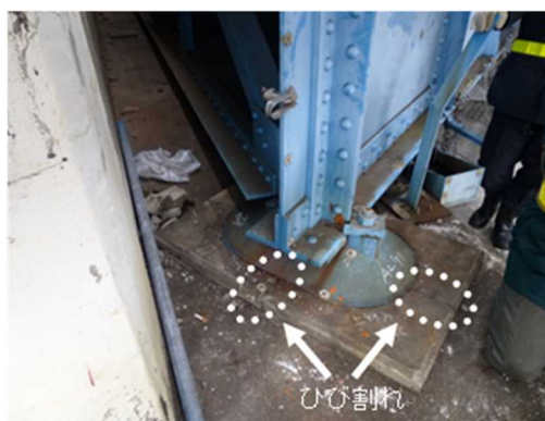
沓座モルタルのひび割れ事例
