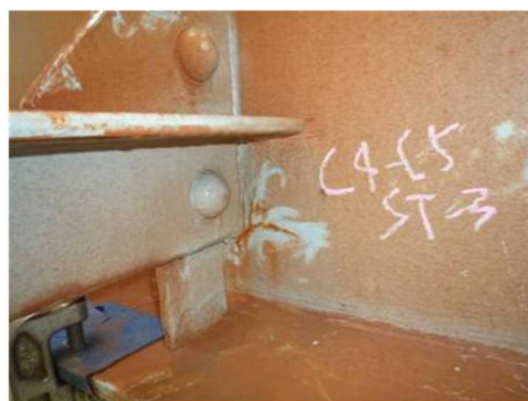
中間補剛材下端における疲労き裂
