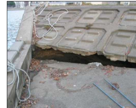
クラックが生じた河川護岸
