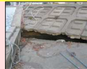
クラックが生じた河川護岸
