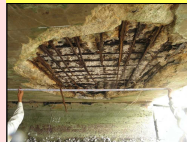
内部の鉄筋が露出した橋梁
