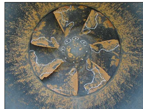
腐食した排水ポンプ場の羽根車
