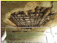
内部の鉄筋が露出した橋梁
