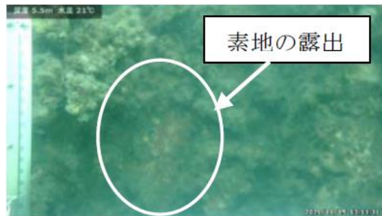
写真2. 素地の露出部
