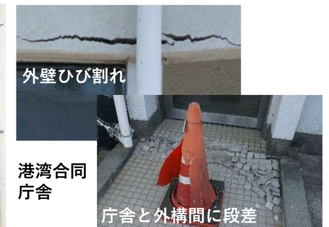
官庁施設の被害状況
