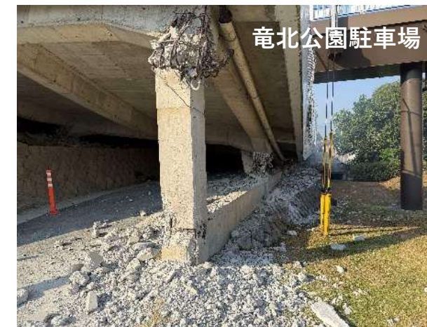
公園の被害状況
