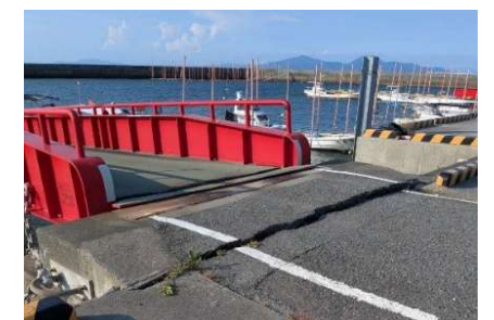
漁港の被害 (浮桟橋接続部のクラック)
