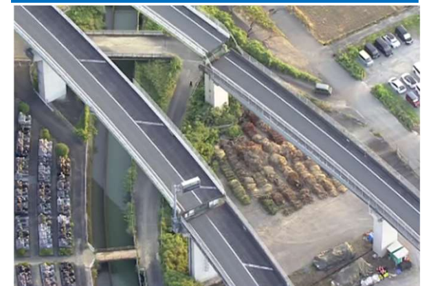
■防災ヘリによる被災状況調査
