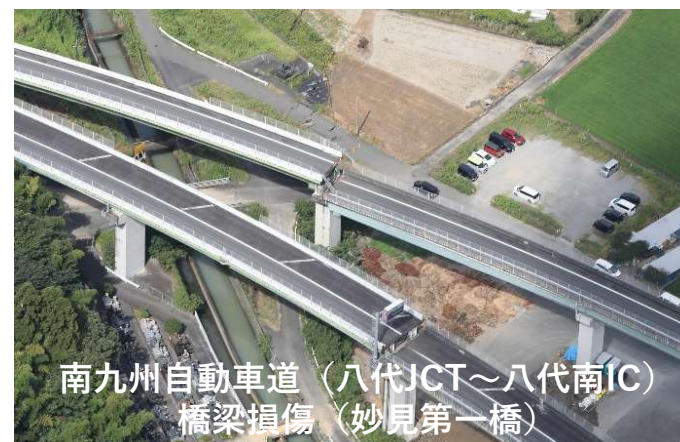
道路の被害状況
