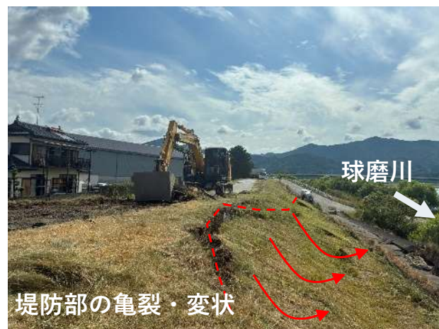
河川の被害状況
