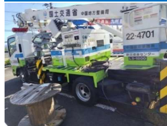
■照明車による電源支援
