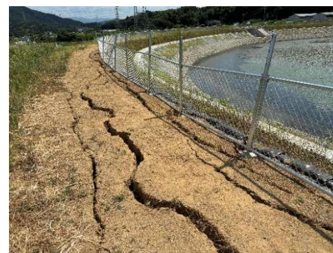
ため池の被害 (堤体上部の亀裂)
