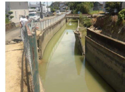
農業用水路の被害 (水路壁の損壊)
