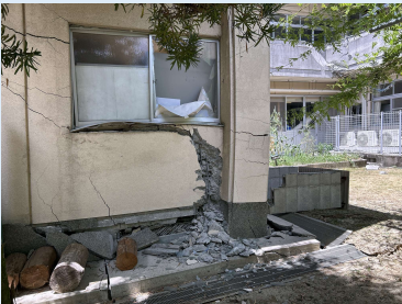
校舎のコンクリート壁ひび割れ等（八代市立龍峯小学校）
