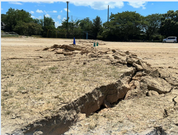
グラウンド地割れ（断層）（八代市立龍峯小学校）
