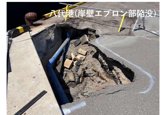
港湾施設の被害状況
