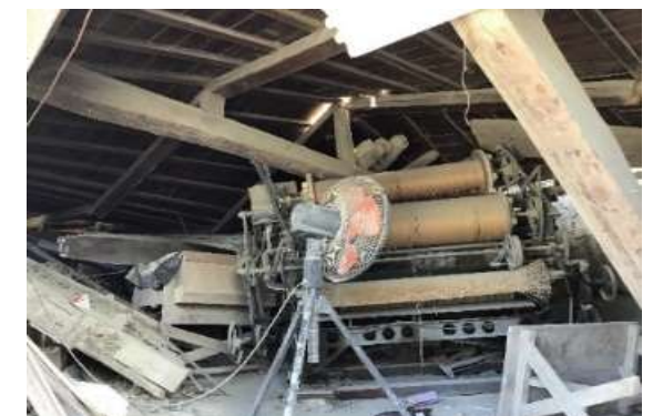
いぐさ製織作業場の倒壊
