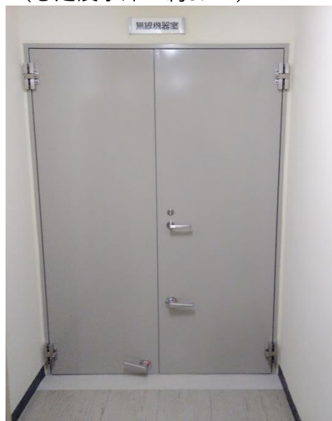
対策状況(止水扉)
