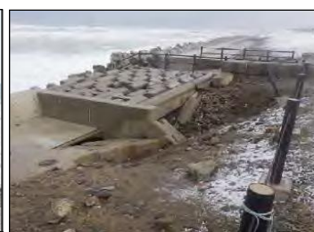
被害状況 (H30.1.23)
