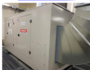
自家発電設備
