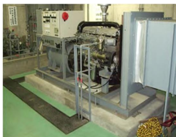
自家発電設備（改修前）
