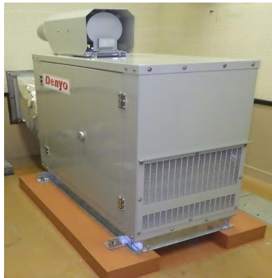
予備電源の整備
