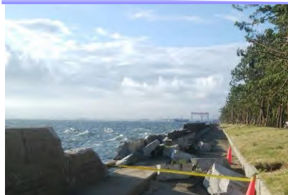
越波による護岸の倒壊
