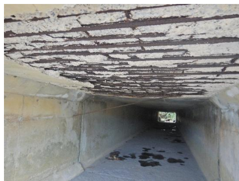
図-7 塩害により被害を受けた構造物
