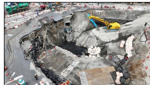
埼玉県八潮市の道路陥没事故 (2025/2/12撮影)
