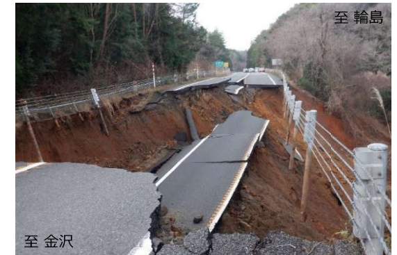
令和6年能登半島地震による被災状況 (のと里山海道：徳田大津IC～横田IC間)
