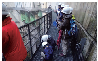
管理用の柵では隙間が大きいため危険なため網フェンスで対応
