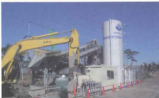
ソイルセメント製造プラント
