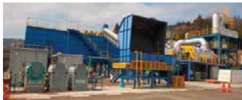
木質バイオマス発電設備
