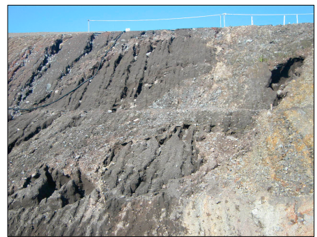
法面の浸食状況
