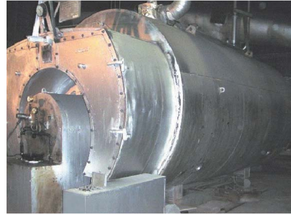
ボイラーの保温材
