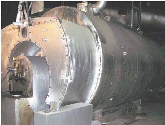
ボイラーの保温材
