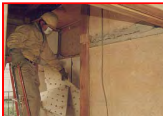
内装材(写真は石綿非含有建材)の取り外し (建築設備等も取り外す)
