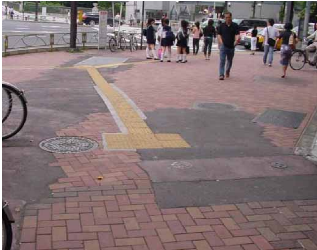
インターロッキングブロック舗装の不適切な復旧事例
