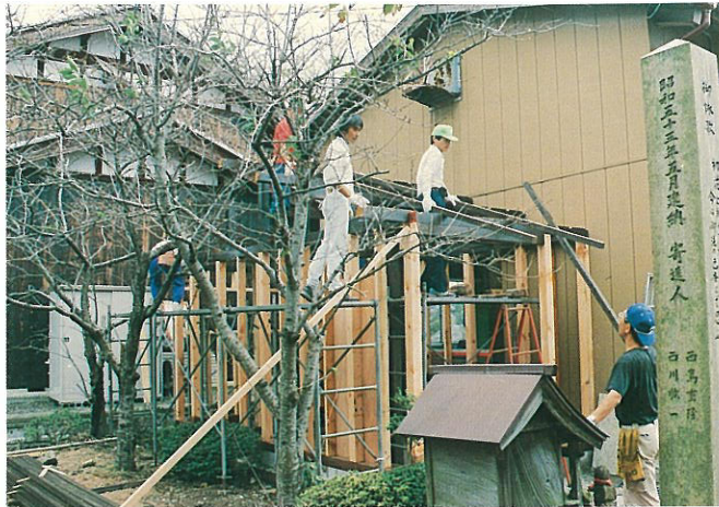
大工職人をはじめ地域の人々の協力によって建設が進められた
