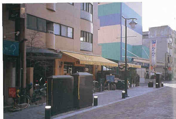
防災や美観に配慮して電線類は地中化されている
