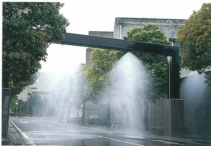
災害時に考慮して設置されたゲートシャワー
