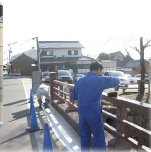
御嶽宿に架かる「唐沢橋」の欄干もローラと刷毛で塗り替え
