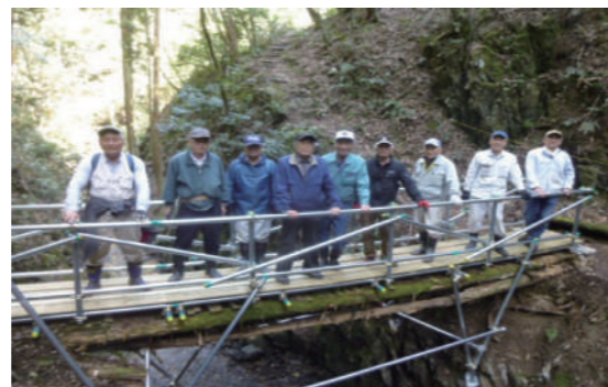
西山古道で杉の丸太橋を手摺付きのパイプ橋に架け替え
