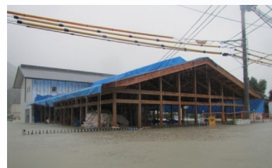
村の駅ひだか(建設中) 浸水状況(H26.8)
