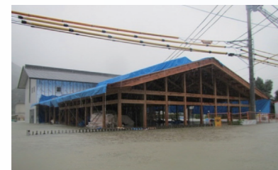
村の駅ひだか(建設中) 浸水状況(H26.8)
