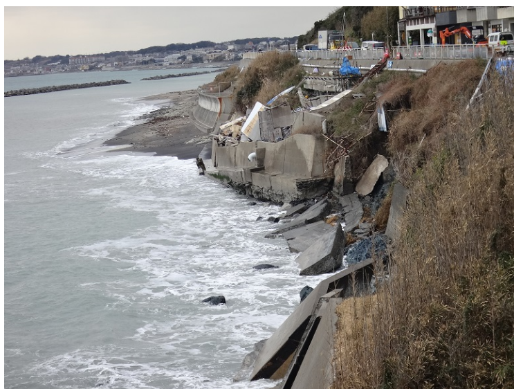
図 2.2 護岸の決壊状況
