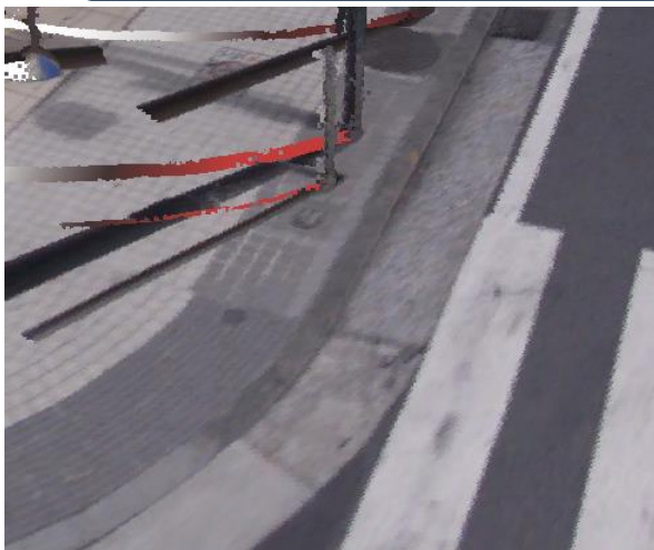
段差2cm以上 (歩道と車道の段差部)
