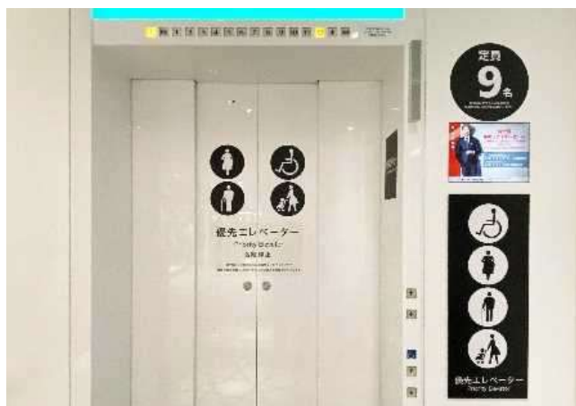
図3.4.10 出入口扉における優先案内の表示例
