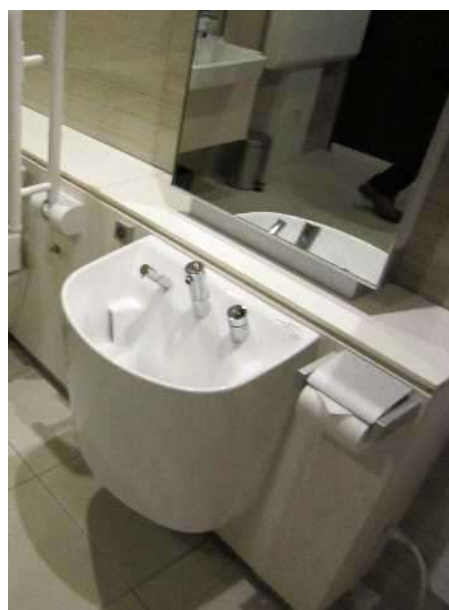
図 3.3.8 オストメイト用設備の設置例
