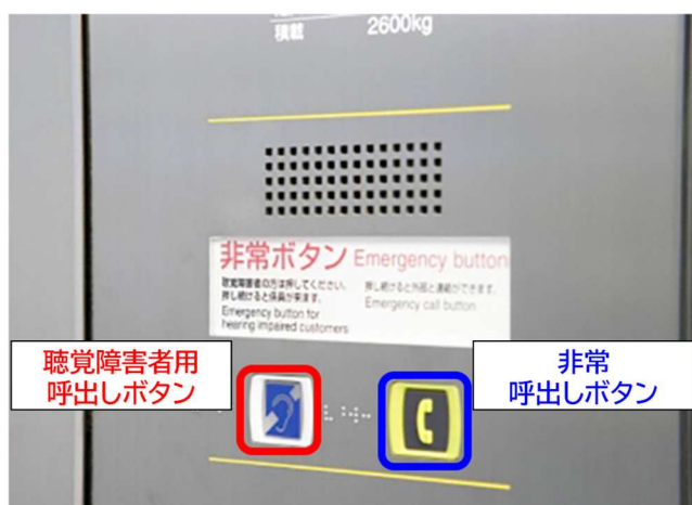
図 3.4.8 非常呼出しボタンの設置例
