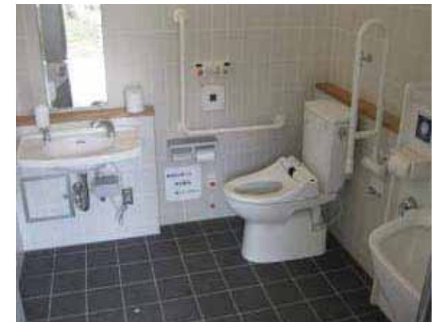
多目的トイレ
