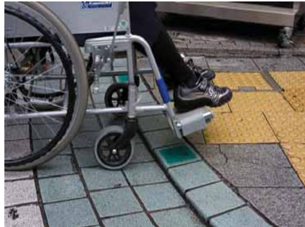
歩道上の段差
