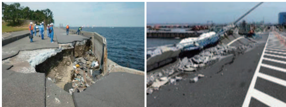
横浜港金沢地区の護岸被災 (令和元年台風第15号)
