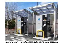
EVバス充電施設の設置
