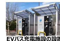
EVバス充電施設の設置
