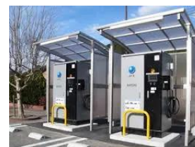
充電施設 蓄電池
