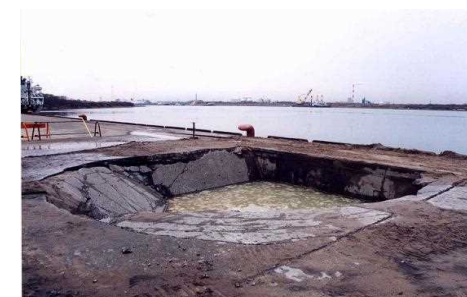
陥没した港湾施設のエプロン部分
