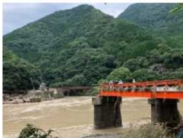
橋梁流失(熊本県道 深水橋)
