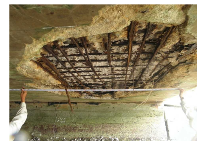
内部の鉄筋が露出した橋梁
