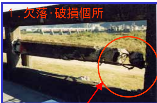
鉄筋露出・コンクリート剥離等
