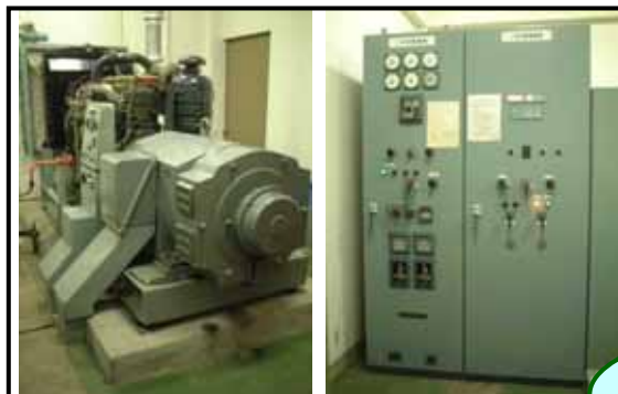
(発電機 + 自立型配電盤)
