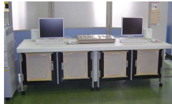
監視操作設備
