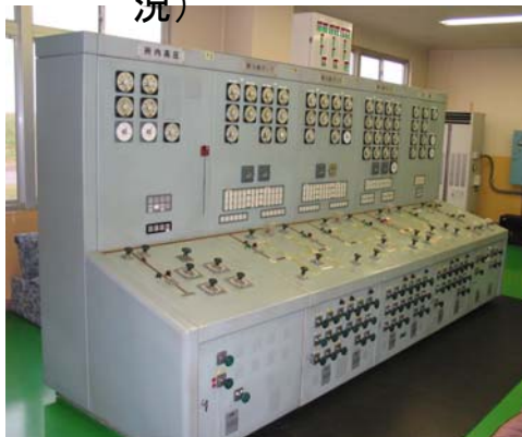
監視操作盤（現況）
