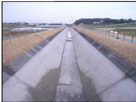
ライニングの変状(クラック)状況
